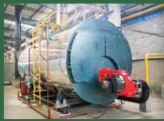
KETEL UAP PIPA API
